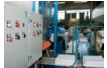
Sistemi automatizzati in lavanderia
